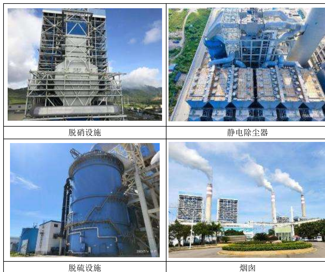
图 3.8-1 现有工程主要废气污染防治设施
